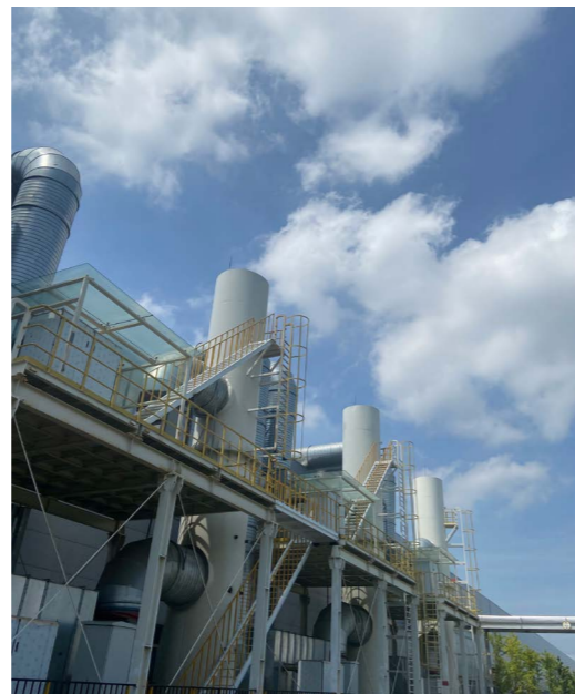
工厂内部粉尘处理装置
